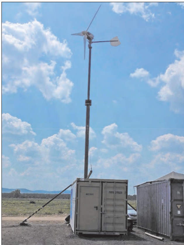
14. ábra. Mivel még a kábeleket is betemették, ha nem lenne az árukladó szélturbina, semmi sem mutatná, hogy ebben a konténerben található a Pfisterer MEMS-e
